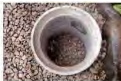
雨水浸透ます
