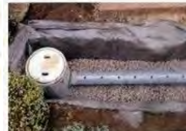
浸透（トレンチ）管
