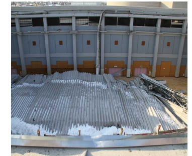
体育館の屋根崩落被害(埼玉県)
