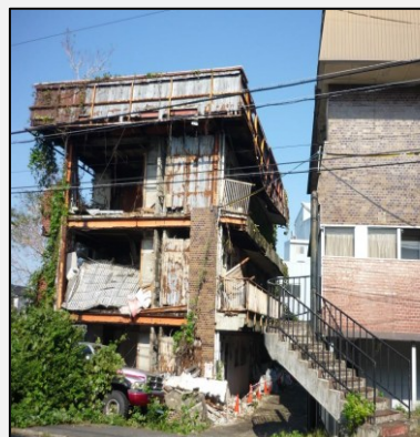
保安上危険な状態として行政代執行した事例
