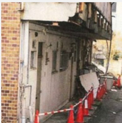
外壁剥落等の危険な状態
