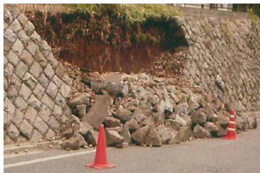
地震による練石積み擁壁の落下 (砧地域)
