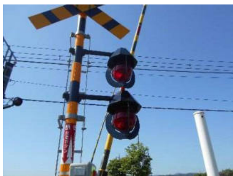
全方位式警報灯 (JR五日市線 淵上第一踏切)
