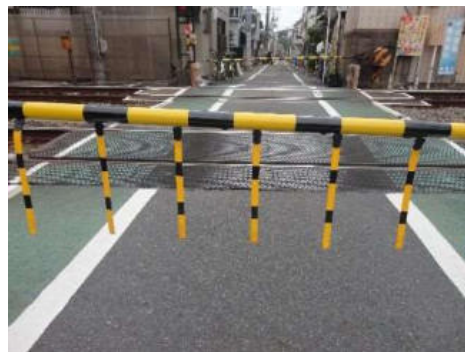
遮断棒 かん たれベルト (西武池袋線 椎名町第8号踏切)
