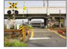
遮断機・警報機の整備
