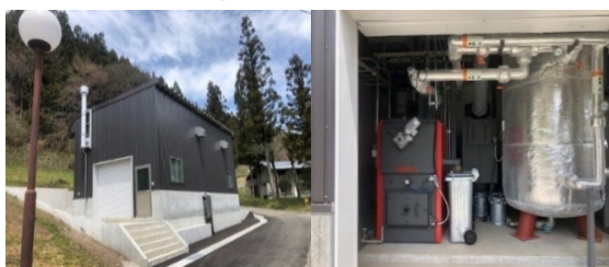
木質バイオマスボイラー
