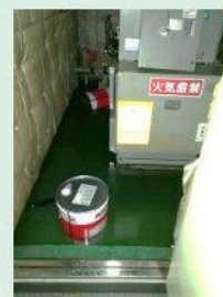
地下 EV 機械室が 水没した様子
