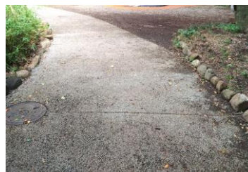
透水性舗装(岡本公園)
