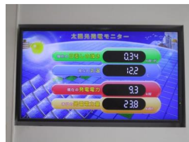
発電状況等モニターの例
