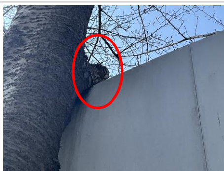
②大枝、樹皮欠損(フェンス接
