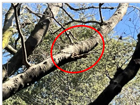
① 大枝、樹皮欠損腐朽(多数あり)
