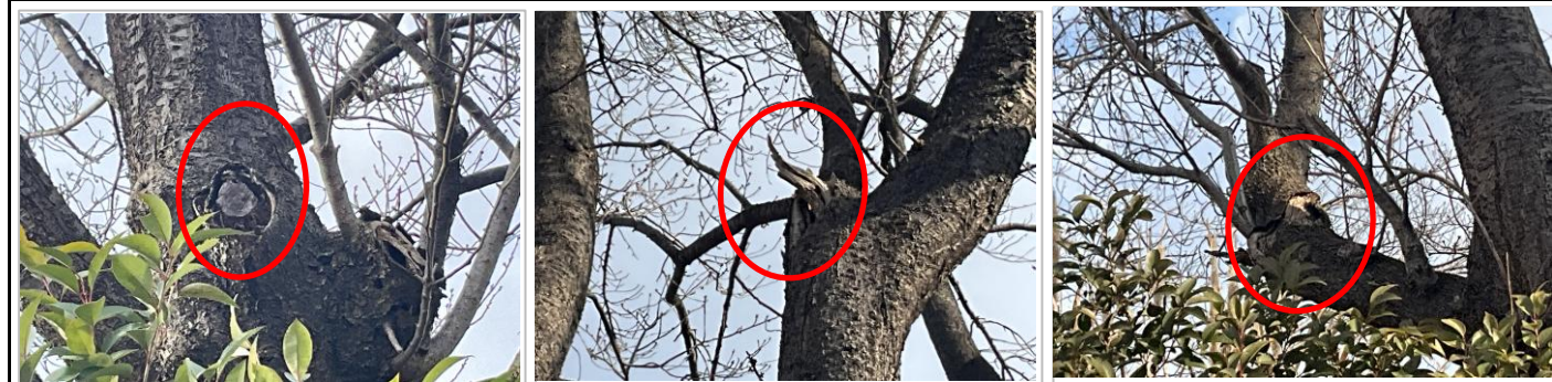
① 大枝、樹皮欠損腐朽
