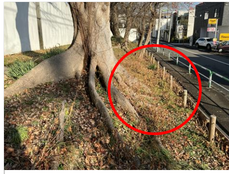
③ 大谷石側のり面
