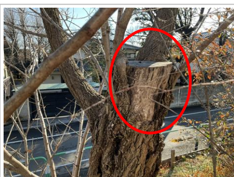
② 幹、樹皮欠損腐朽
