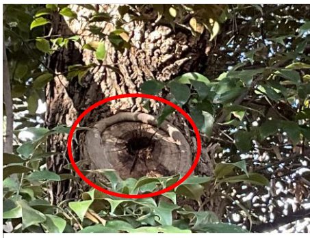
② 幹、樹皮欠損腐朽
