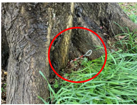
②鋼棒貫入異常
