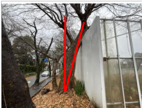
① 幹、広場側に傾きあり
