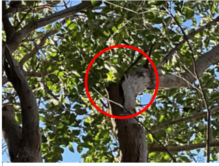
②大枝、樹皮欠損腐朽
