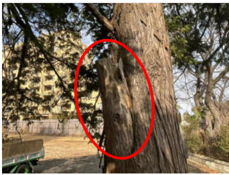
② 幹、樹皮欠損腐朽
