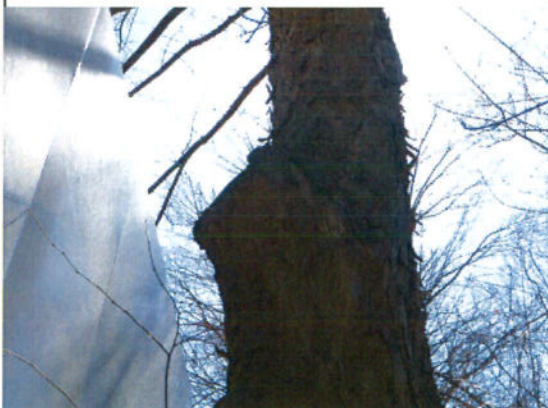
①開口空洞あり
