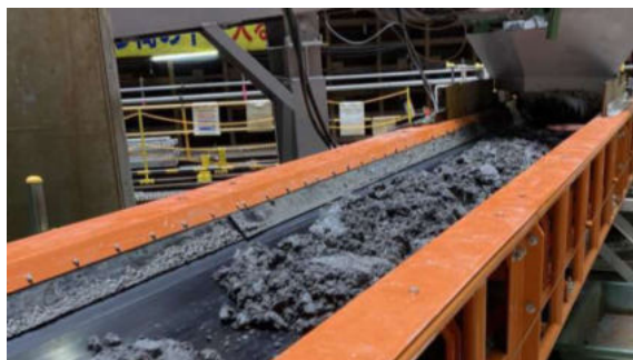
排出された土砂の様子
