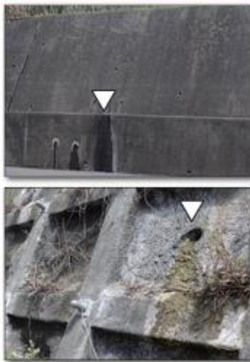
地下水の流出
