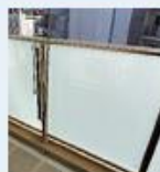
転落防止のための 手すり
